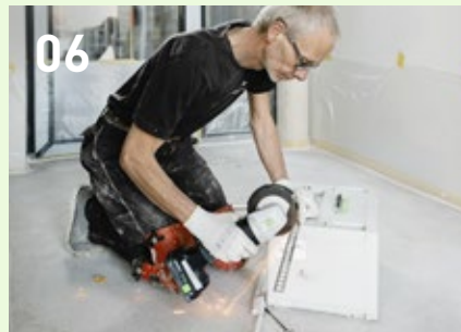
Anschlusschienen mit dem Winkelschleifer AGC 18 auf Maß zuschneiden und als Dehnungsfugen einspachteln.
