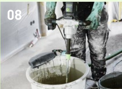
Komponenten (hier Pandomo Floor Plus) anrühren mit Hilfe des Rührwerks MX 1600/2. TIPP: Die Absaugung MX-A reduziert die Staubeentwicklung beim Einrühren erheblich.
